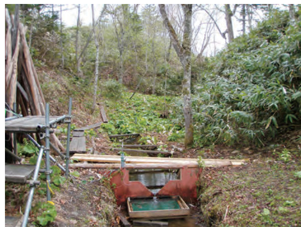
写真-5 集水域末端に設置された量水堰。水質および流量観測を行っている（北大天塩研究林）。
